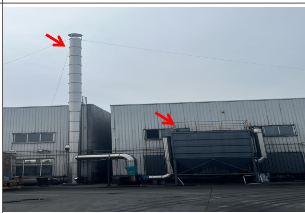
钢丝打包工序废气-1 套袋式除尘器+1 根 18m 高排气筒
