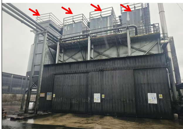
炭黑出料、输送、入仓及包装工序废气-4 套脉 冲袋式除尘器+1 根 18m 高排气筒
