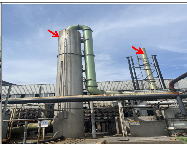
热裂解尾气处理设施废气-脱硫喷淋塔+1 根 18m 高排气筒
