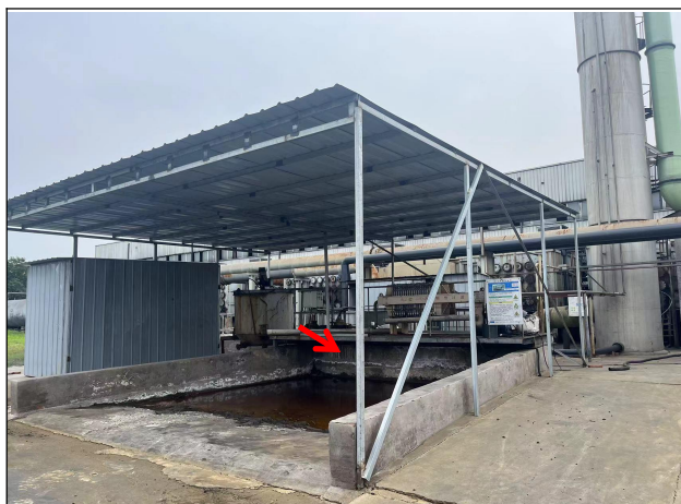
热裂解尾气处理设施废气-双碱法湿法脱硫池+ 脱硫喷淋塔
