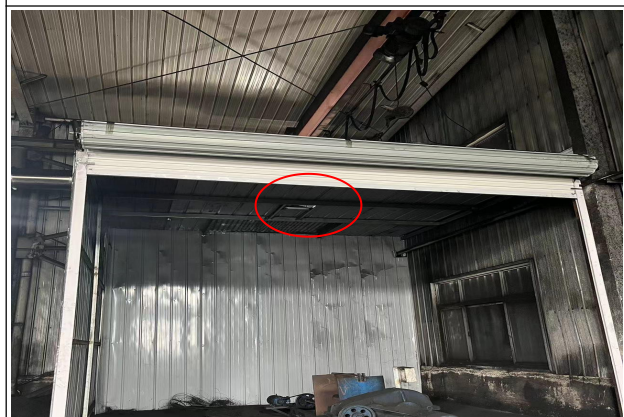
钢丝打包工序隔间及废气集气口
